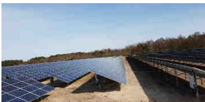
Figur 1: Solceller monteret på faste stativer
