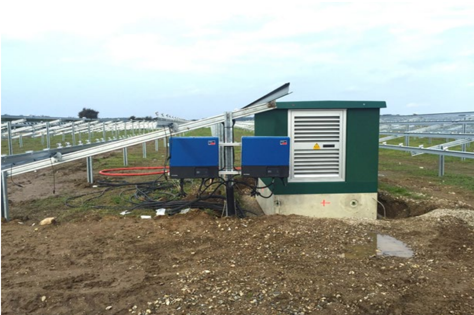
Invertere (blå) og step-up transformere i anlægget
