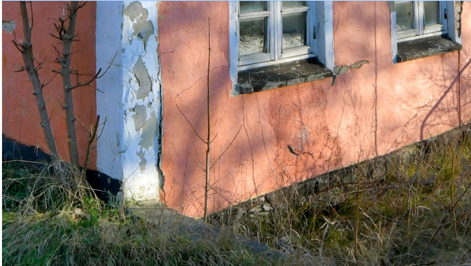
BAVNEHØJVEJ 1 | REVNE MELLEML GAVL OG FACADEMUR
